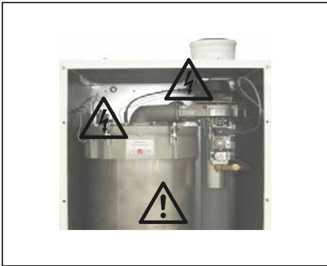
Ábra: Gyűjtőtrafó, nagyfeszültségű gyűjtőelektróda, hőcserélő Áramütésveszély veszélye, Égési sérülés veszélye forró alkatrészek miatt
